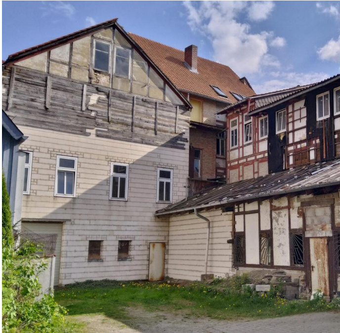
Wie man Fachwerk ruiniert: Haus in der Bergstraße von Goslar
